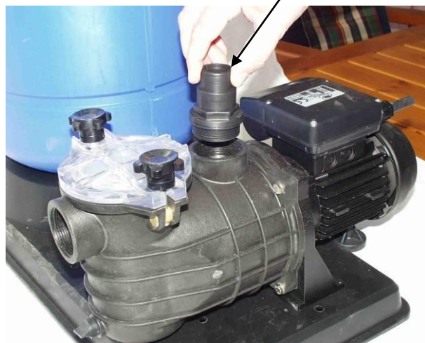
Från pumpens rygg mot sandfiltrets 6-vägsventil
